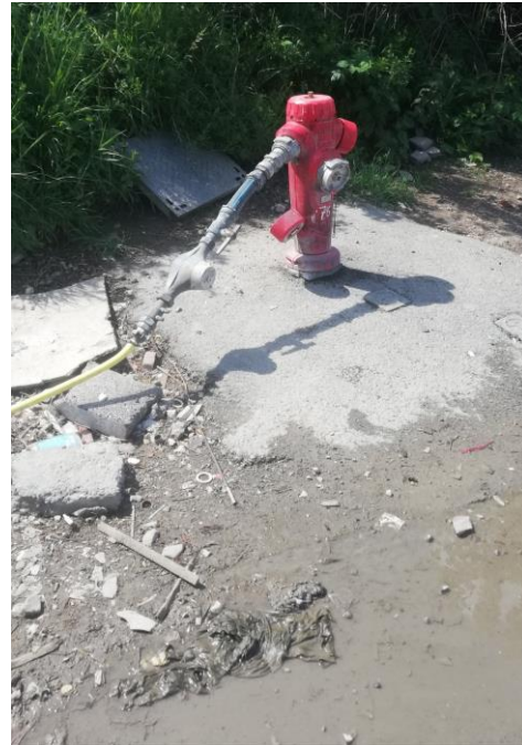
Raccordement sur une borne Incendie avec compteur
